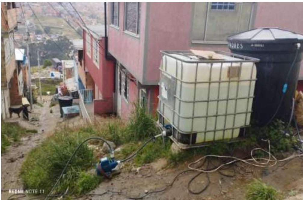
Foto tanques de agua
