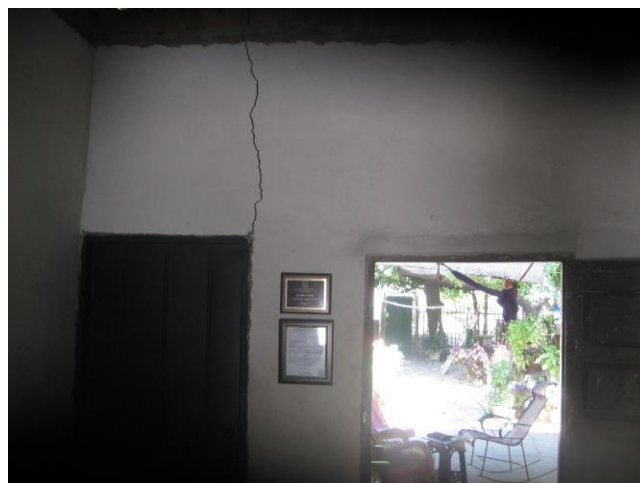
Una de las grietas que presenta la vivienda de la señora Nilva María Soto Romero por cuenta de las explotaciones que se realizan en El Cerrejón (Archivo personal: enero de 2017).
